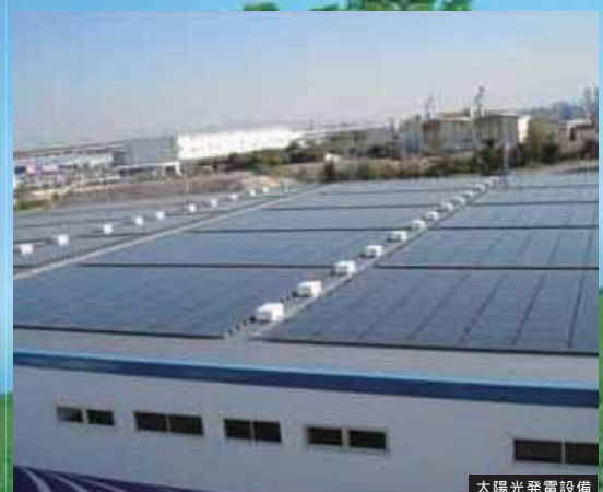
太陽光発電設備
